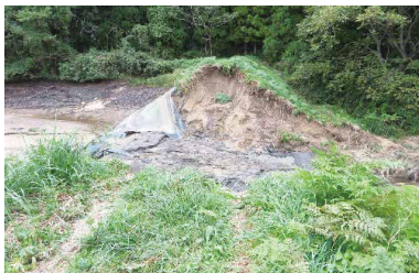
決壊した農業用ため池(白石市)
