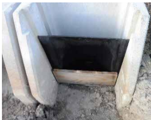
田んぼダム対応排水柵・堰板
