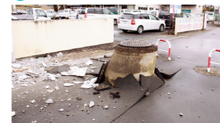
震動による液状化で、マンホールが地上に大きく突き出す被害が、各地で発生しました。
