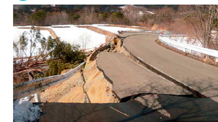
地震により、県道南蔵王七ヶ宿線で法面が崩落するなど、大きな道路被害が発生しました。
