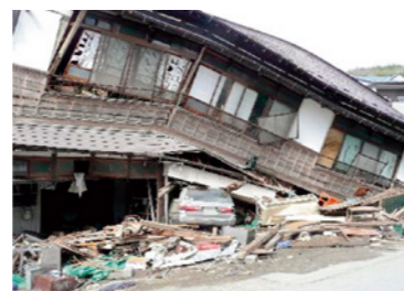
写真:倒壊した家屋(気仙沼市)
