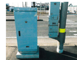
写真:自動起動式発動発電機
