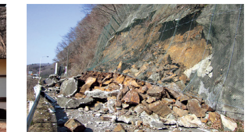
写真:川崎町(がけ崩れが発生した道路)
