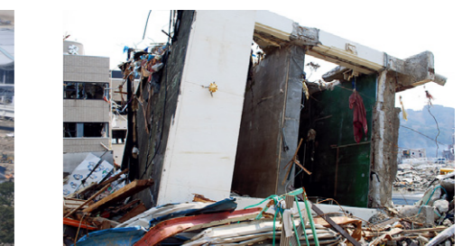
写真:女川町(津波により横倒しになった女川交番)
