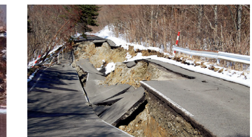
写真:セケ宿町(崩落した道路)
