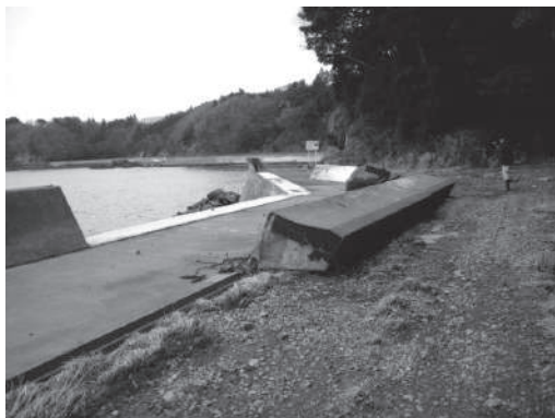
写真 農地海岸の被災状況（南三陸町）
