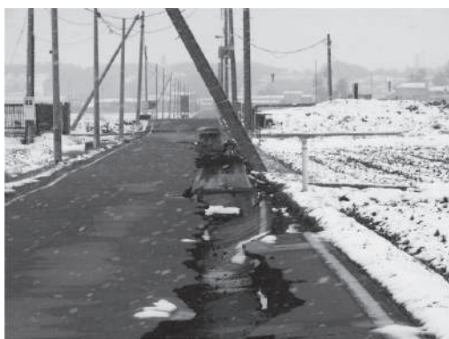
写真 農業集落排水処理施設の被災状況（大崎市）
