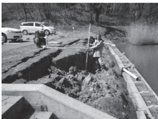
写真 ため池の被災状況（白石市）
