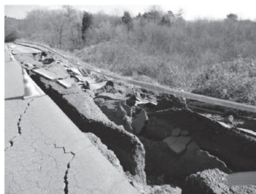
写真 農道の被災状況（蔵王町）
