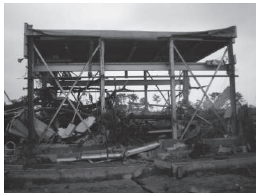
写真 排水機場の被災状況（仙台市）
