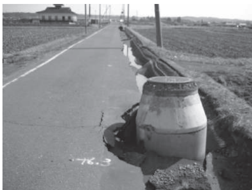
写真 農業集落排水管路施設の被災状況 (大崎市高柳地区)
