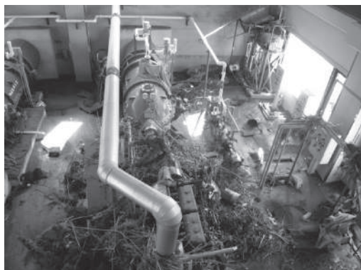
写真 被災直後の排水機場 (H23. 3)
