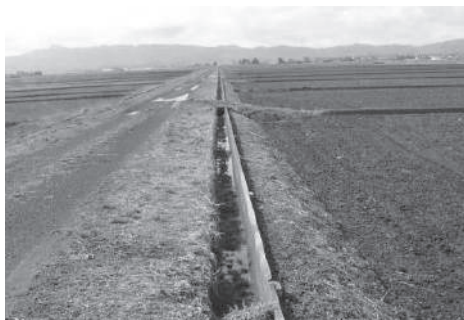
写真 小用水路に縦断方向不陸発生
