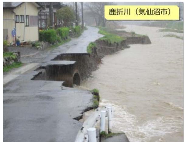
平成 24 年 5 月低気圧による大雨で河岸浸食が生じた鹿折川
