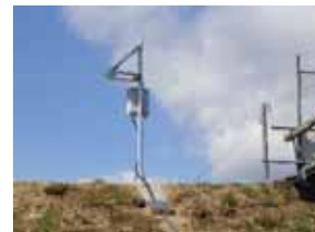
危機管理型水位計 (新川・村田町)
