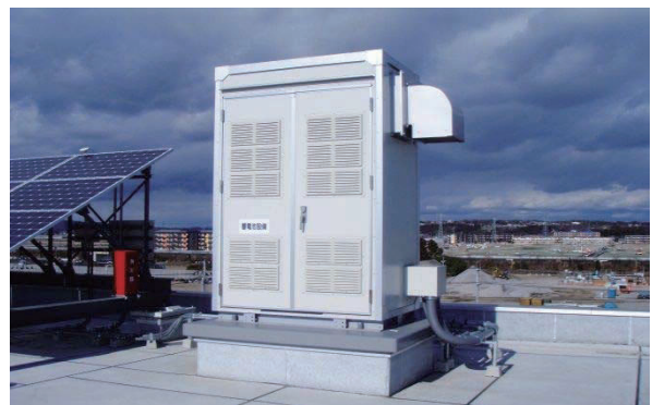
図 2-166 蓄電池設備の設置事例
