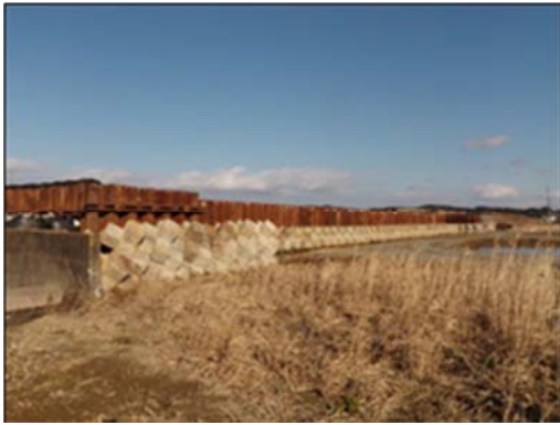
▲一級河川 出来川 涌谷町新名鱈地内 堤防（川裏）決壊状況
