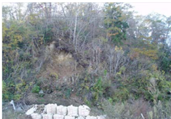
▲(一) 清水浜志津川港線 南三陸町志津川字清水地内 道路法面被災状況
