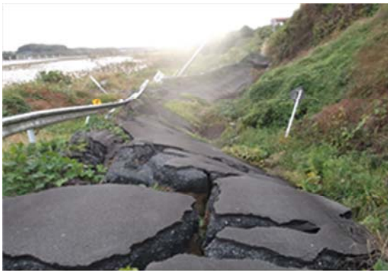
長沼川 登米市迫町新田字大形地内 ブロック張被災状況
