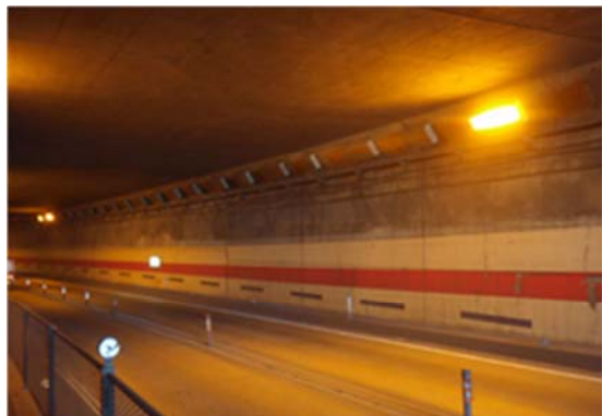
▲仙台空港トンネル 岩沼市下野郷地内 トンネル照明〔低圧ナトリウム灯〕(仮復旧後)
