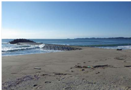
▲大曲海岸 東松島市大曲地内 3号突堤沈下状況
