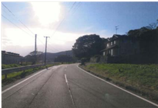
▲(主)仙台村田線 村田町菅生字館地内 311地震災168号 路面被災状況
