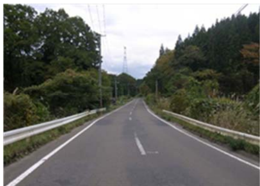
▲ (一) 鳴子池月線 大崎市池月上宮地内 道路路面被災状況
