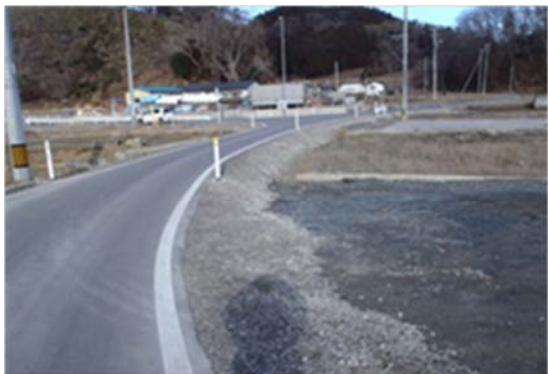
▲ (主) 気仙沼唐桑線 気仙沼市宿浦地内 応急嵩上げ道路状況
