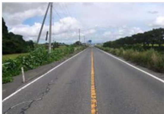
▲(国)346 号線 松島町幡谷地内 路面被災状況
