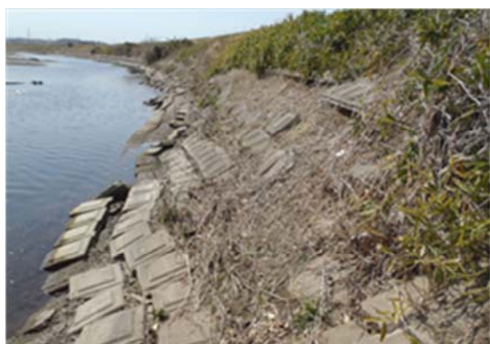
▲七北田川 仙台市宮城野区岩切地内 被災状況
