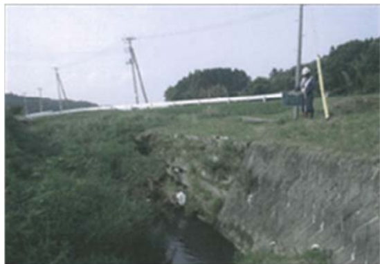
▲滑川 黒川郡大郷町鶉崎地内外 被災状況
