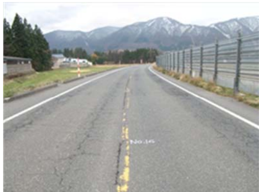
▲ (一) 沼倉鳴子線 大崎市鳴子温泉地内 道路路面被災状況
