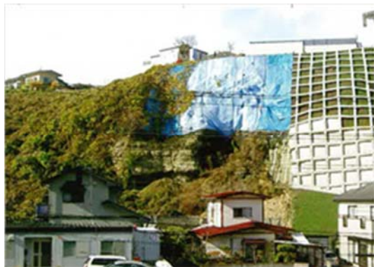
▲黒川郡富谷町東向陽台地内 被災状況
