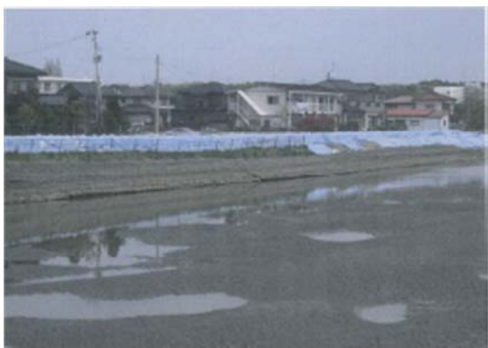
▲砂押川 多賀城市鶴ヶ谷地内 被災状況
