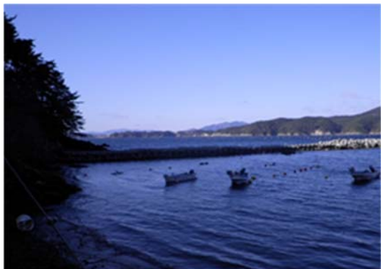
▲唐桑海岸 栃浜地区海岸 突堤(2) 沈下状況
