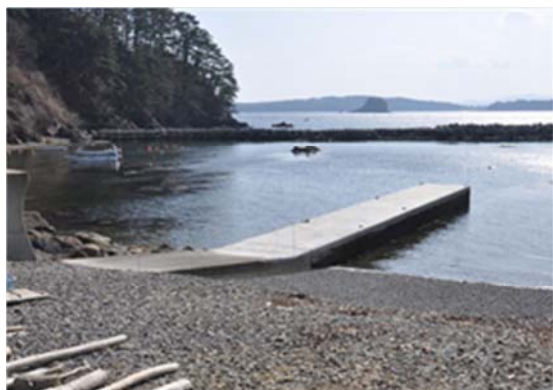
▲唐桑海岸 栃浜地区海岸 突堤(1) 沈下状況
