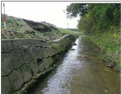
▲一級河川 田尻川 大崎市古川中雨生沢地内 堤防法面崩壊状況
