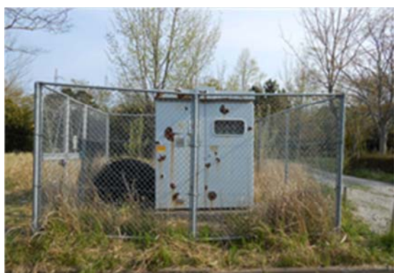
▲仙台港多賀城地区緩衝緑地 多賀城市大代地内 配電盤被災状況
