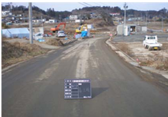
▲ (一) 泊崎半島線 南三陸町名足地内 道路面亀裂状況
