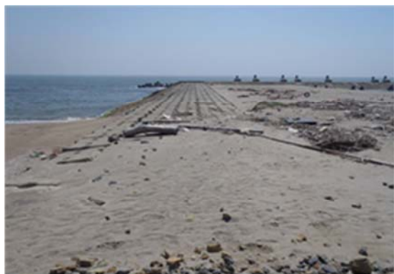
▲浜市海岸 東松島市浜市地内 1号突堤沈下状況
