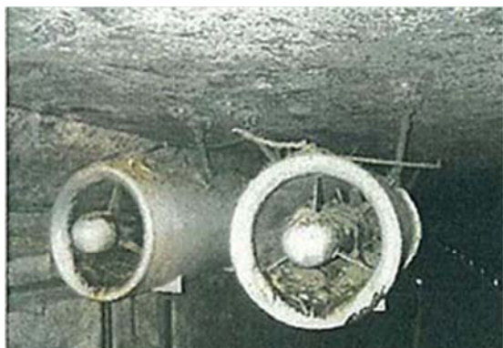
▲仙台空港トンネル 岩沼市下野郷地内 ジェットファン〔φ600〕被災状況
