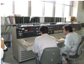
警報所からの放送・サイレン吹鳴
