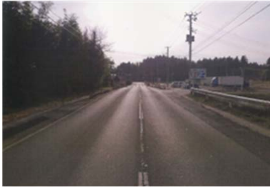
▲(国)113線 角田市横倉字今谷地内 路面被災状況
