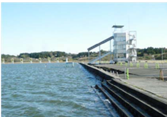
長沼川 登米市迫町北方字天形地内 矢板式護岸被災状況
