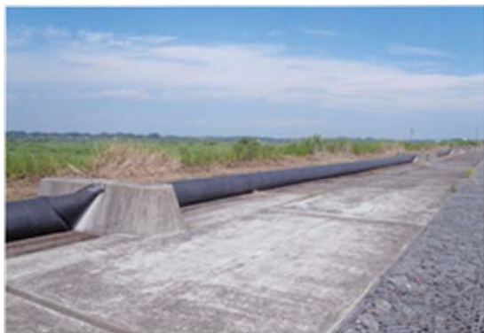
▲野谷地越流堤 登米市南方町新野谷地内 越流堤沈下状況
