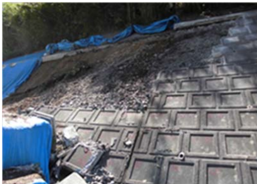
▲ (一) 馬場只越線 気仙沼市馬場地内 ブロック張り崩壊状況
