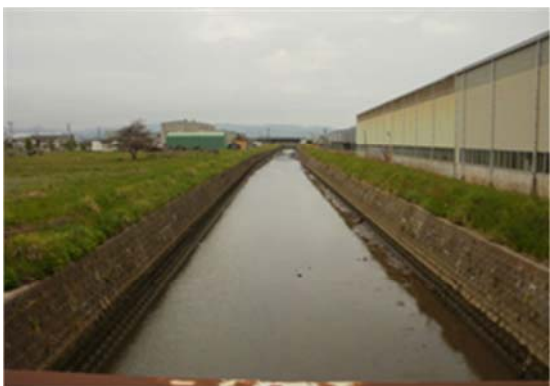
▲川内沢川 名取市地内 被災状況
