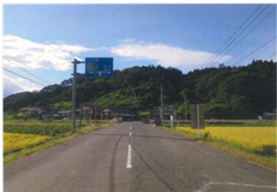
▲(一)名取村田線 村田町菅生字寺下地内 311地震災222号 路面被災状況
