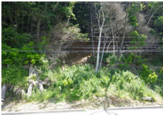
▲平成 24 年 7 月 7 日着工 大浜外道路災害復旧工事 法面崩壊状況
