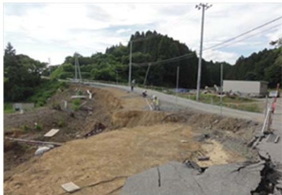
▲(一) 清水浜志津川港線 南三陸町志津川字深田地内 路面等被災状況
