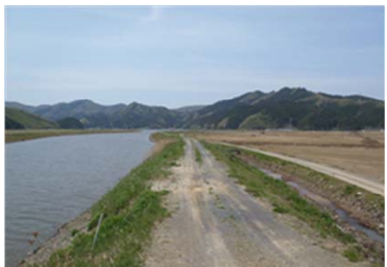
▲平成 25 年 4 月 24 日着工 富士川河川災害復旧工事 石巻市針岡地内
