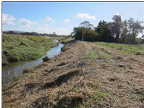
▲一級河川 田尻川 大崎市田尻中目地内 堤防法面崩壊状況
