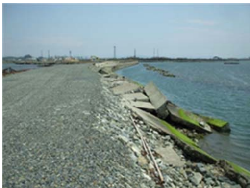
▲東名地先海岸 東松島市大塚地内 被災状況
