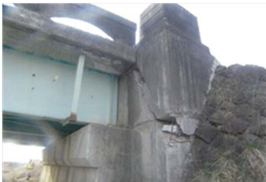
▲主) 古川佐沼線 栗原市高清水台町地内 透川橋橋台被災状況
