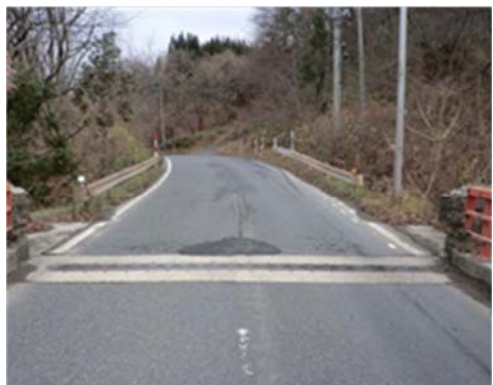
▲国道 108 号 大崎市鳴子温泉見手野原地内 道路路面被災状況
