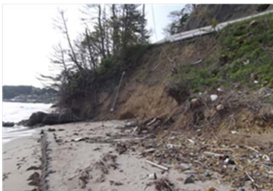
▲ (一) 泊崎半島線 南三陸町長須賀地内 道路法面崩壊状況
