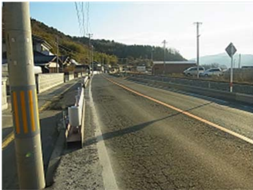
▲国道 398 号 石巻市沢田地内 路面被災状況
