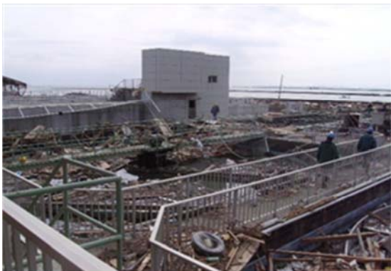
▲平成 23 年 3 月 21 日被災状況 石巻東部浄化センター2 系列水処理施設最終沈殿池
