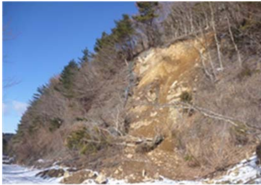
▲ (一) 牡鹿半島公園線 石巻市新山浜地内 法面崩壊状況
