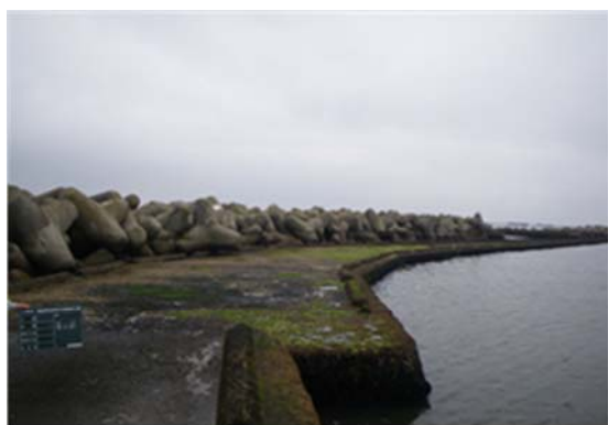
▲雲雀野防波堤被災状況 地震による沈下
