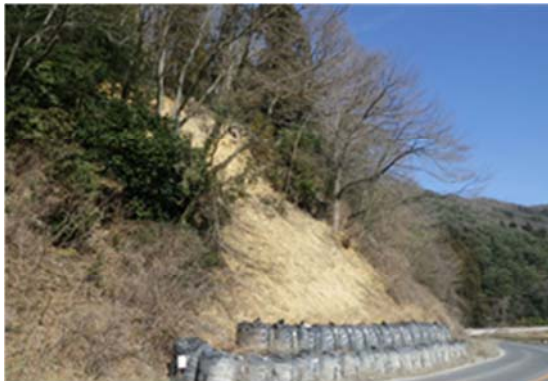
▲国道 3 9 8 号 石巻市釜谷地内 道路法面崩壊状況
