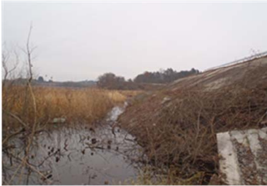
長沼川 登米市迫町北方字羽河地内 ブロック張被災状況
