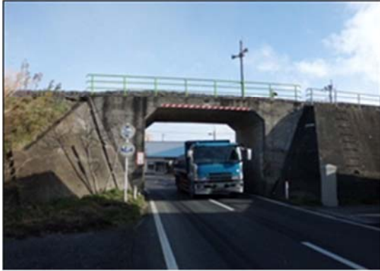
▲主要地方道涌谷津山線 登米市豊里町下屋浦地 内 J R 気仙沼線アンダーボックス狭隘・線形不良
