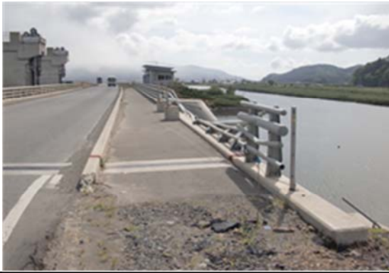
▲国道 398 号 石巻市北上町十三浜地内 新迫波橋 車両用防護柵破損状況
