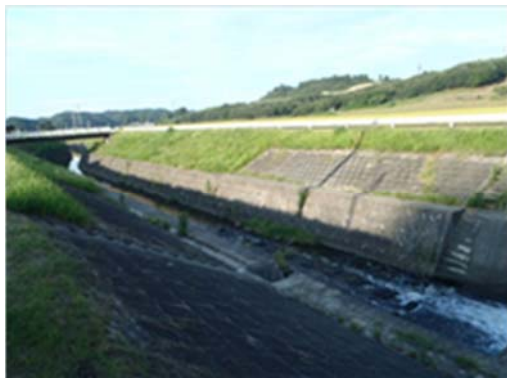
▲明石川 富谷町西成田地内 被災状況
