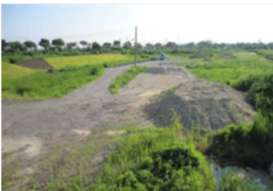
▲川内沢川（放水路） 名取市植松地内 放水路掘削築堤・護岸工事
