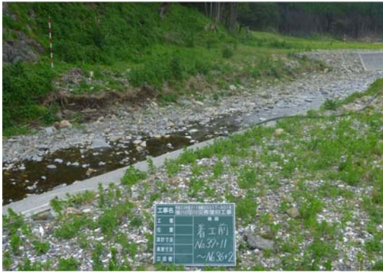
後川災害復旧工事 被災状況
