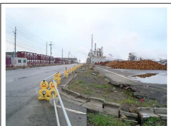
臨港道路東1号線石巻市市雲雀野町地内 路面被災状況
