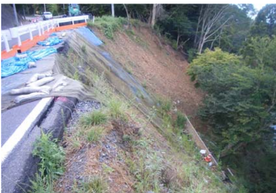
▲(主)石巻鮎川線 石巻市桃浦地内 路面被災状況
