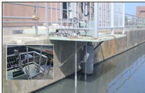
▲放流水質測定装置設置状況
