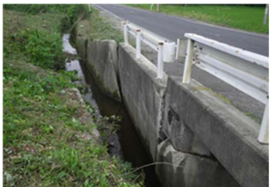
▲ (主) 栗駒岩出山線大崎市岩出山九十田地内 路面被災状況
