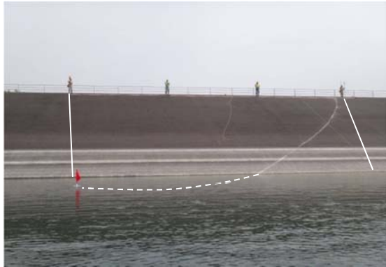
南川ダム 大和町吉田地内 鞍部ダム表面遮水層亀裂範囲状況
