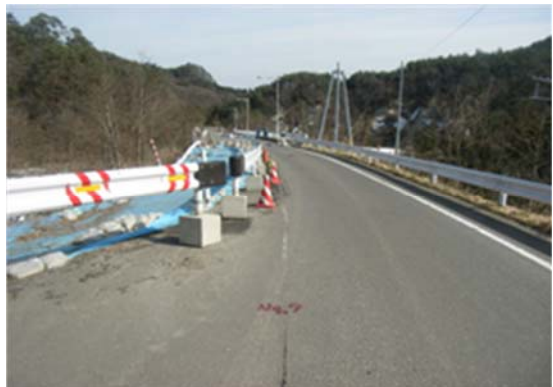
▲ (一) 最上小野田線 加美町宮崎字北地内 路面被災状況
