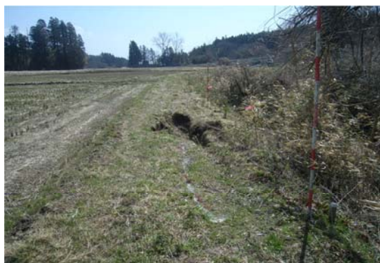
一級河川小山田川 大崎市岩出山磯田地内 堤防クラック・法崩状況
