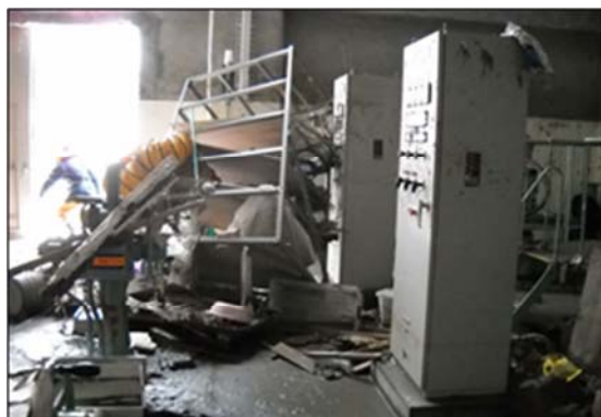
石巻東部浄化センター 中央管理棟内（モーター室） 汚水ポンプ設備被災状況（土砂・瓦礫の流入）
