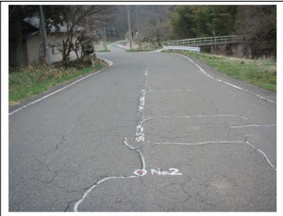
▲ (一) 上八瀬気仙沼線 気仙沼市芳ノ口地内 路面ひび割れ状況
