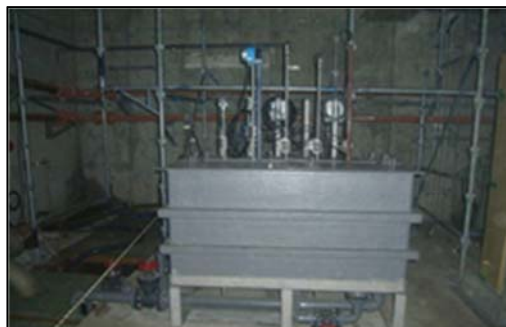
▲流入水質測定装置設置状況
