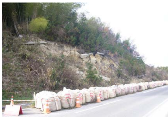
(主) 河南築館線 涌谷町太田地内 道路法面崩壊状況
