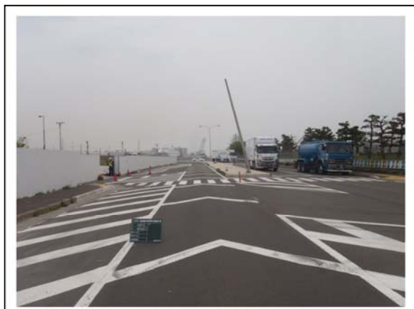
▲仙台港区ふ頭5号線津波被災状況
