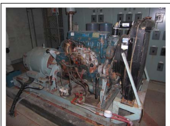
塩釜警察署（塩釜市北浜） 地下1階で冠水した非常用発電機
