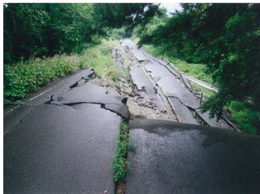
▲（主）南蔵王七ヶ宿線七ヶ宿町柏木山地内 道路崩壊状況
