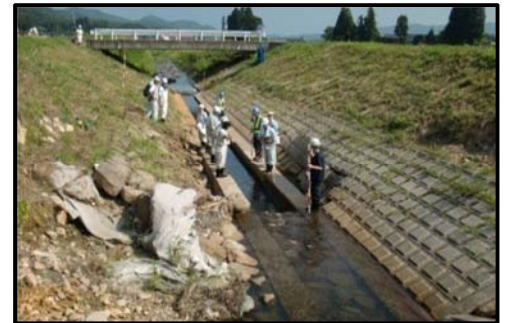
災害査定状況
