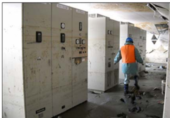
石巻東部浄化センター 脱水機棟1階 電気室被災状況（土砂・瓦礫の流入）
