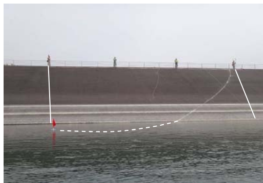
▲ 南川鞍部ダム 復旧前 表面遮水層に亀裂が発生
