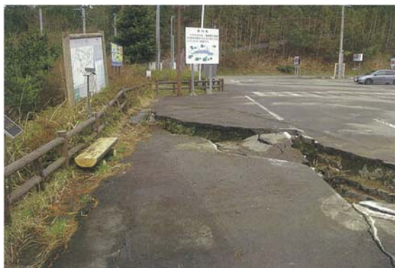
(国)113号 七ヶ宿町字野沢倉山「道の駅」 沈下・亀裂状況
