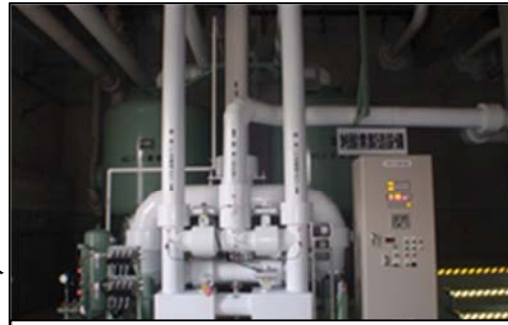
▲純酸素発生装置試運転調整完了
