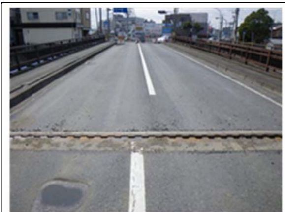
▲国道 398 号 (錦橋) 登米市迫町佐沼地内 橋梁上部横ずれ状況
