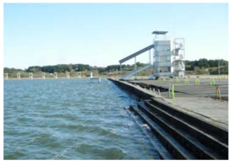
▲長沼ダム 護岸 被災状況
