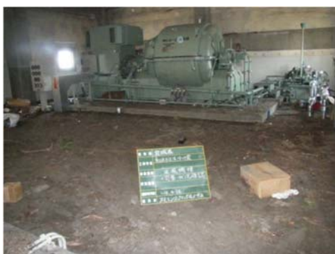
送風機設備被災後 ガレキ・土砂堆積状況
