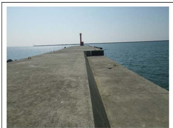
仙台港区新北防波堤 本体、消波ブロック沈下状況
