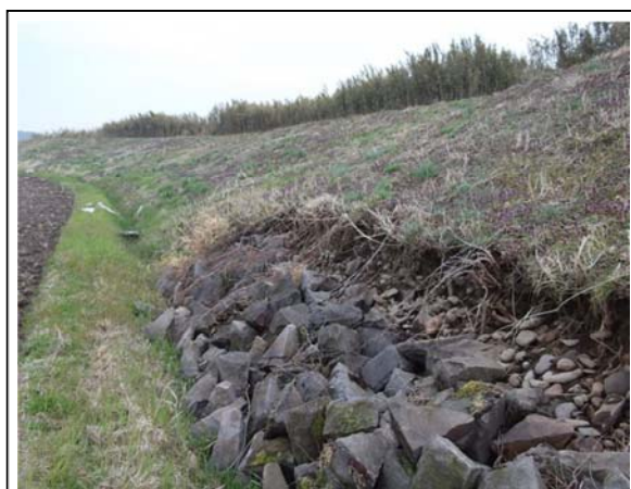
▲小山田川 栗原市高清水鶴巻地内 河川堤防の被災状況
