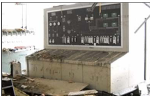
▲監視装置被災状況
