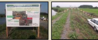
▲定川の復旧事業についての掲示板 ▲定川堤防の丁張 ※丁張とは、橋などを建設する際に用いる目安の定規のことです
