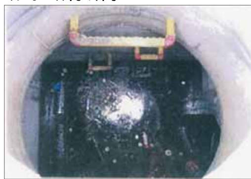
マンホール内の滞水
