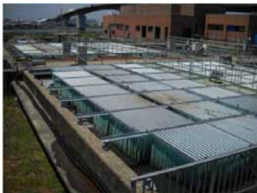
<水処理施設の簡易生物処理（全景）>
