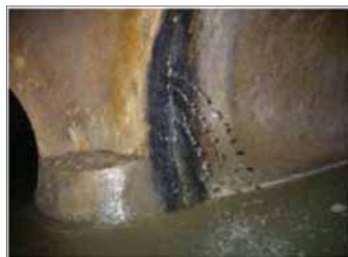
管路内の漏水
