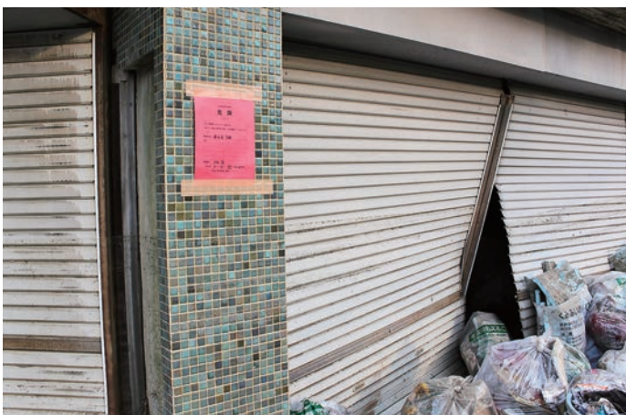
2011.4.1 17時00分 「被災建築物応急危険度判定により危険 (赤色用紙) とされた建物 (早股地区)」
