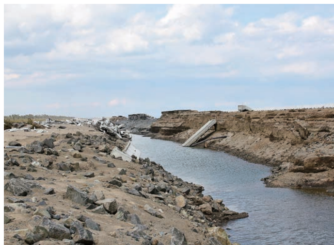
2011.3.28 14時18分 「津波により被災した堤防 (長谷釜地区周辺)」
