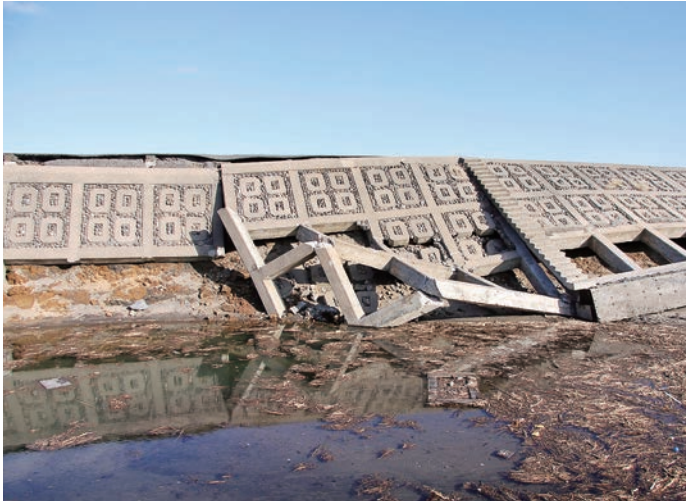
2011.3.18 15時32分 「津波により被災した堤防(長谷釜地区付近)」
