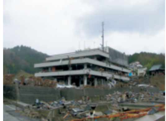
津波により被災し通信が途絶した女川町役場
