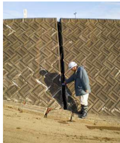
ブロック積みの隙間
