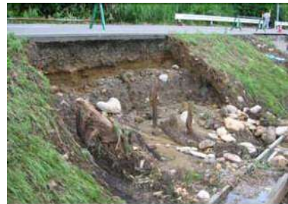
道路法面の崩壊
