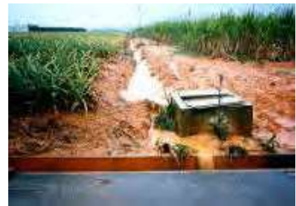
土砂の流出状況
