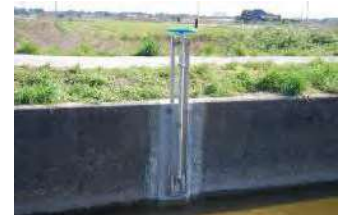
巻き上げ式ゲート（分水用ゲート）
