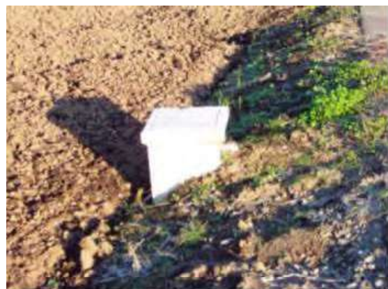
傾いた給水栓ボックス
