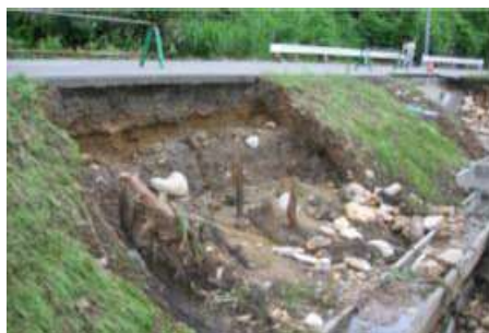
道路法面の崩壊状況
