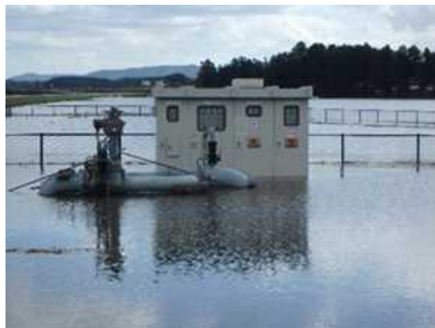
揚水機場の浸水
