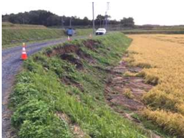
農道の法面崩落
