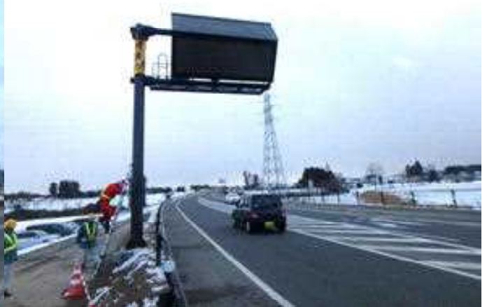
道路情報表示板の設置状況
