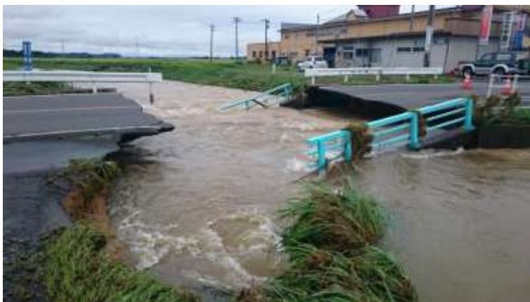
被災状況（上流側より下流側を望む）
