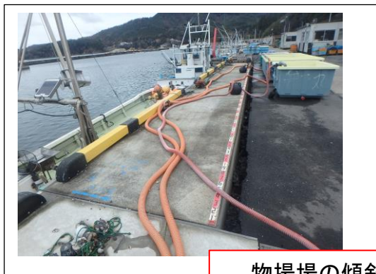
物揚場の傾斜
