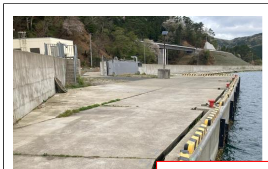
物揚場の傾斜
