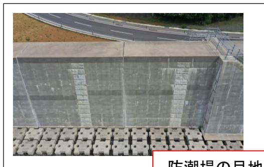
防潮堤の目地開き
