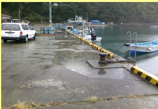
物揚場エプロン部滞水状況
