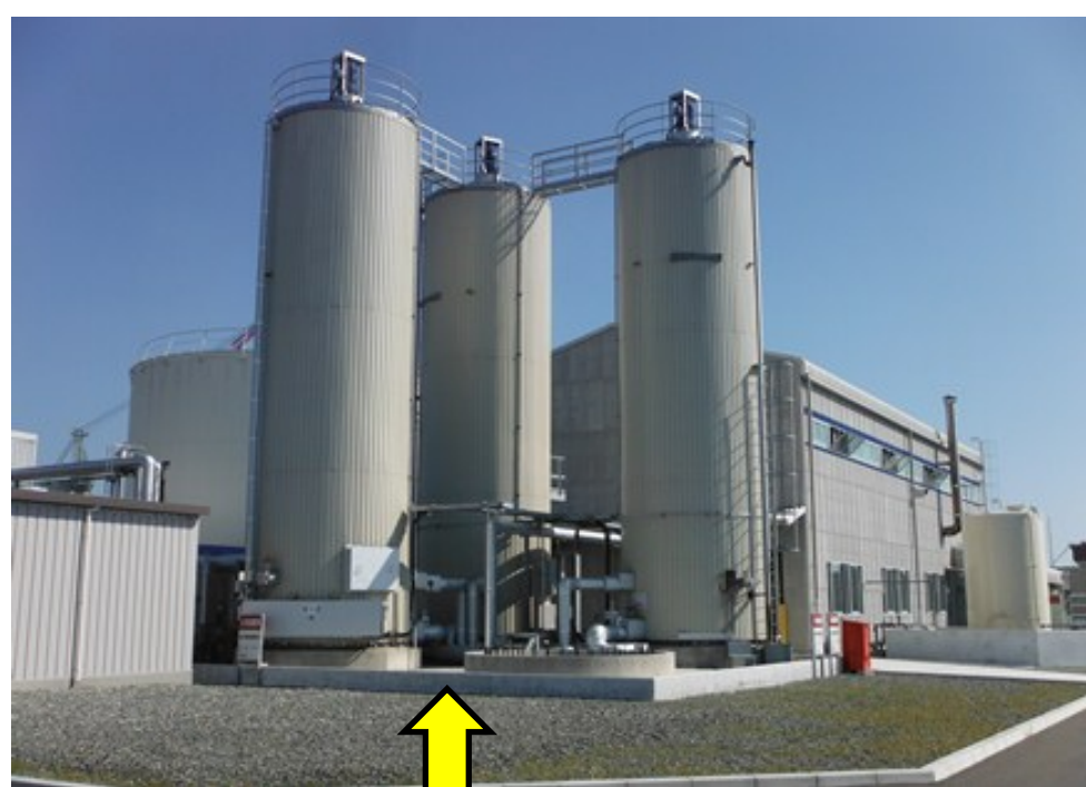
:改質アスファルトタンク
