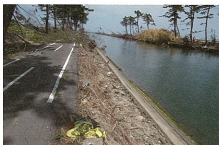
貞山運河の被災状況
