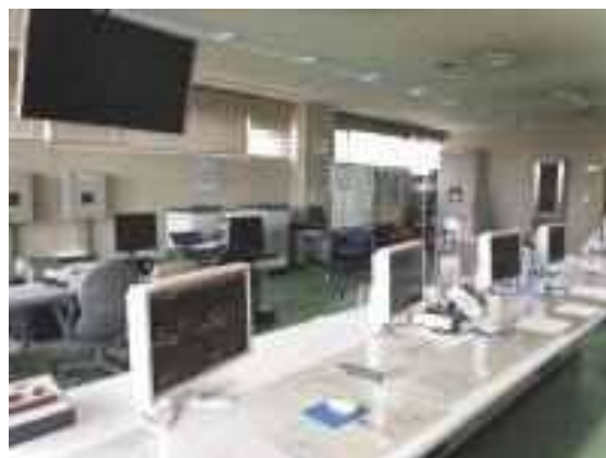
(中央監視制御装置)
