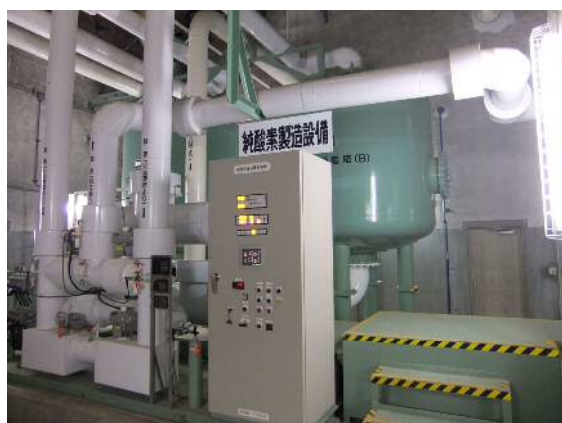
(純酸素製造設備)
