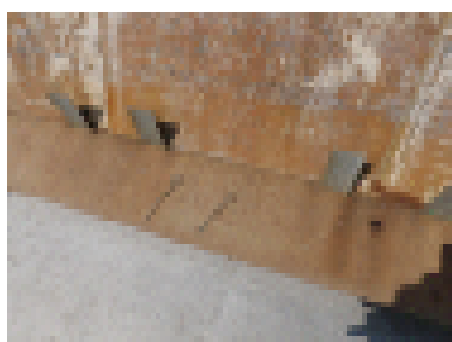
図 4.1.4 ウエザーシールのはずれ
