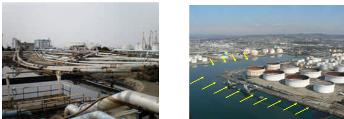
図 5.1.8 津波により湾曲した配管及びオイルフェンス展張状況
