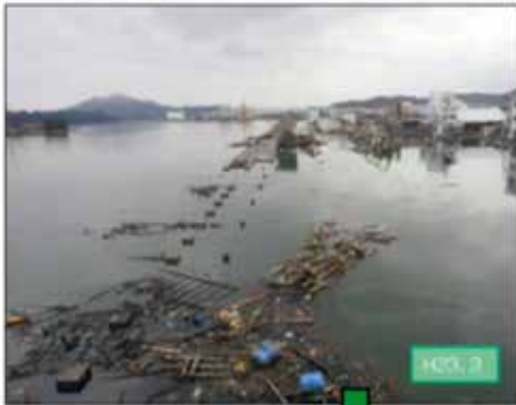
-6.0m岸壁被災状況
