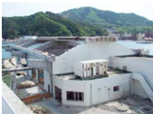
写真 荷さばき施設被災状況
