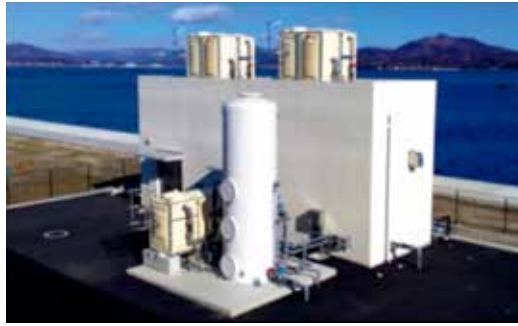
写真 取水ポンプ棟
