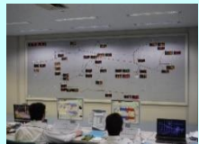
流量・水圧等の監視 (24時間・365日)
