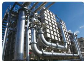
下水処理設備
