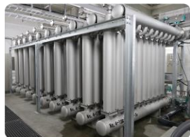
浄水処理設備
