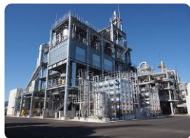
汚泥処理設備
