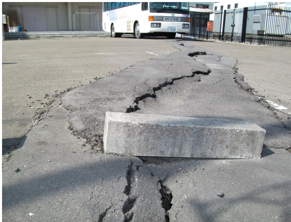
駐車場アスファルトのヒビ
