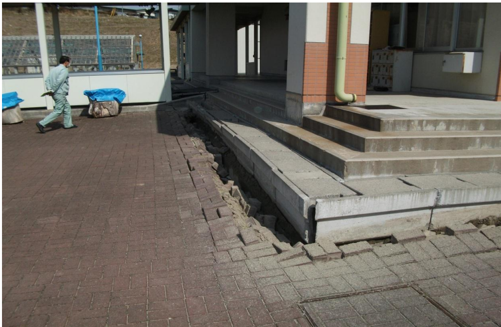
校舎周辺のインターロッキングブロックの沈下
