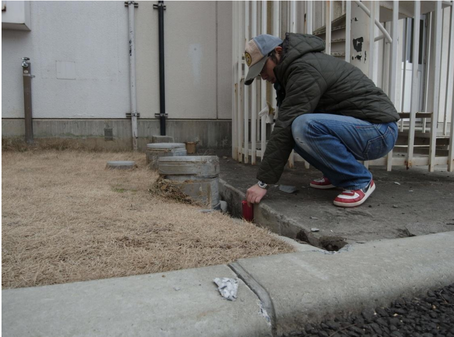
高等部校舎前 地盤沈下
