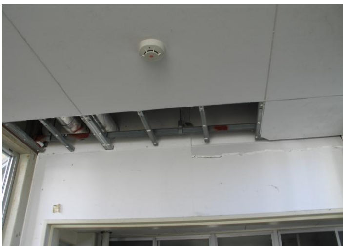
【食堂通路】天井剥落の状況
