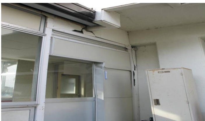
【食堂通路】外部出入口付近の破損状況
