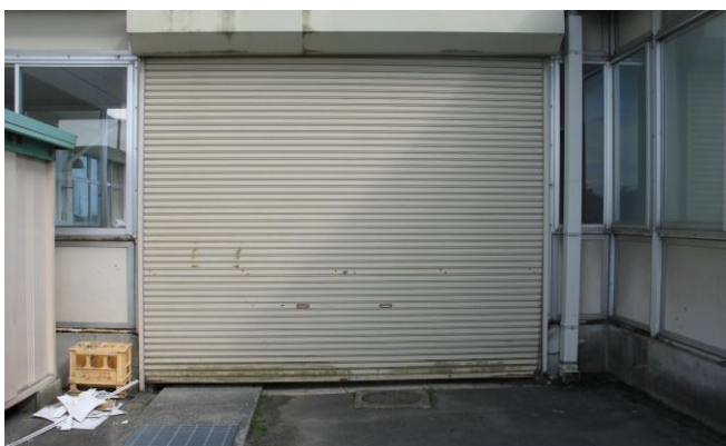
【食堂通路】シャッターの状況（ゆがみにより開閉不可）
