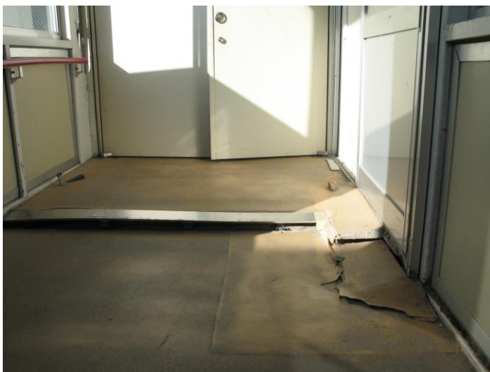
【食堂通路】床の陥没及び亀裂
