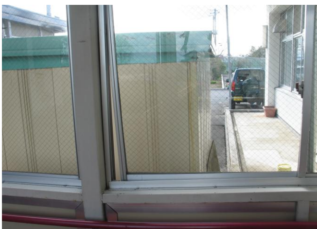
【食堂通路】窓枠の状況（開閉不可）
