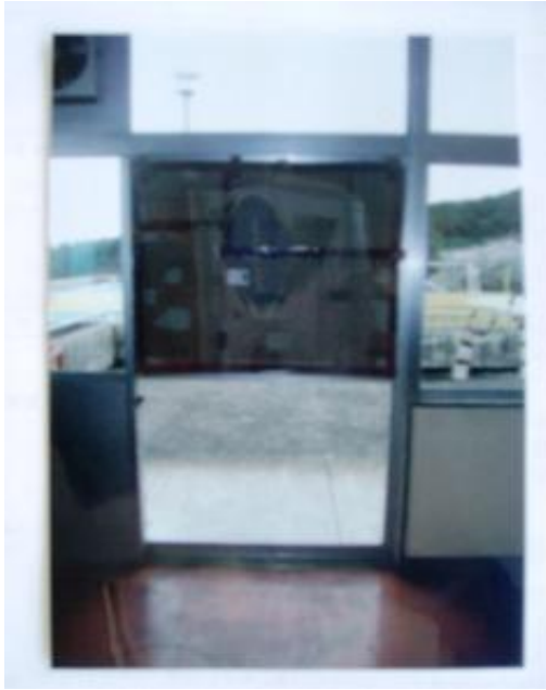
プレイルームガラス破損
