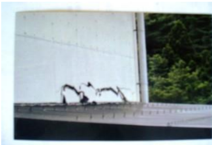
体育館外壁破損
