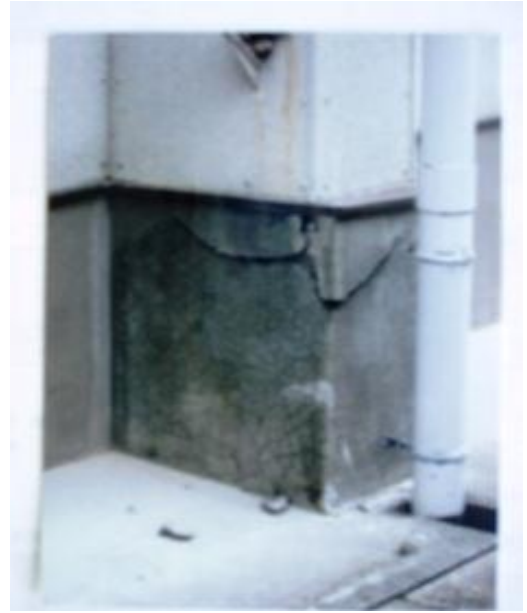
体育館支柱破損
