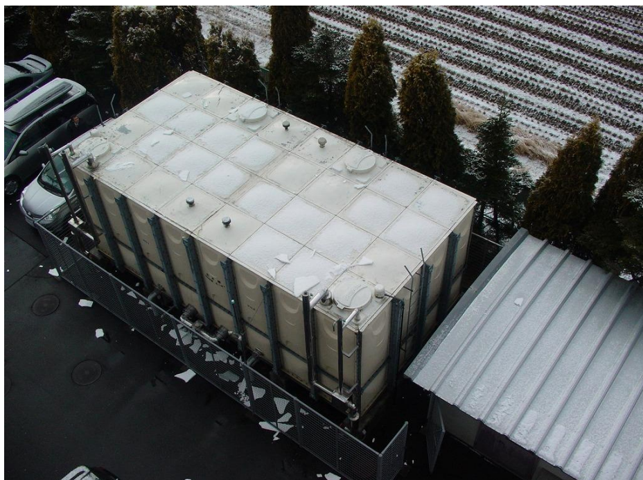
受水槽全景(天板部分の破損)
