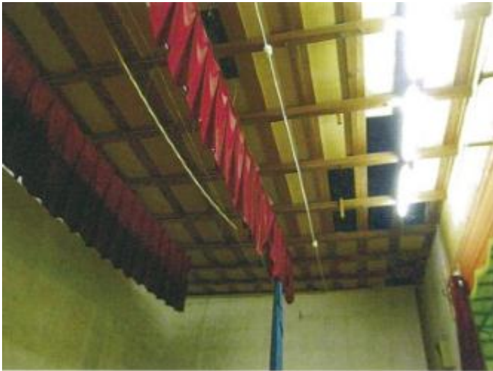
旧体育館ステージ天井落下
