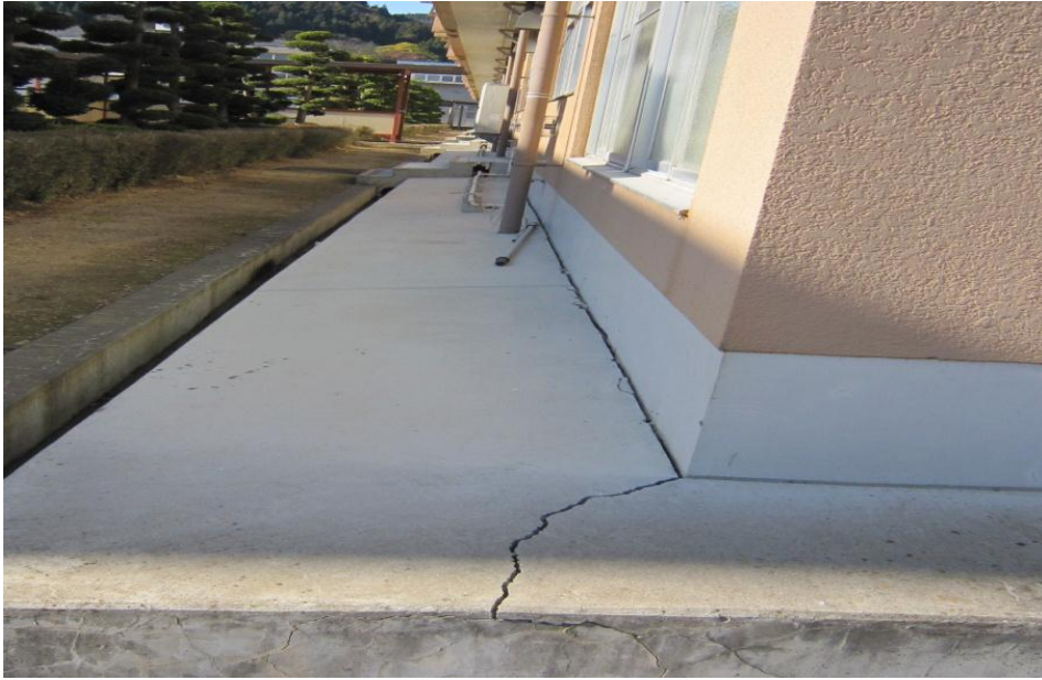
東校舎犬走り亀裂
