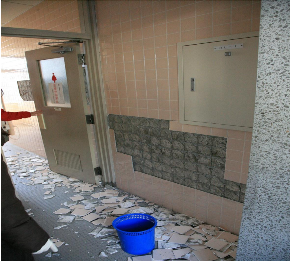
トイレタイル破損
