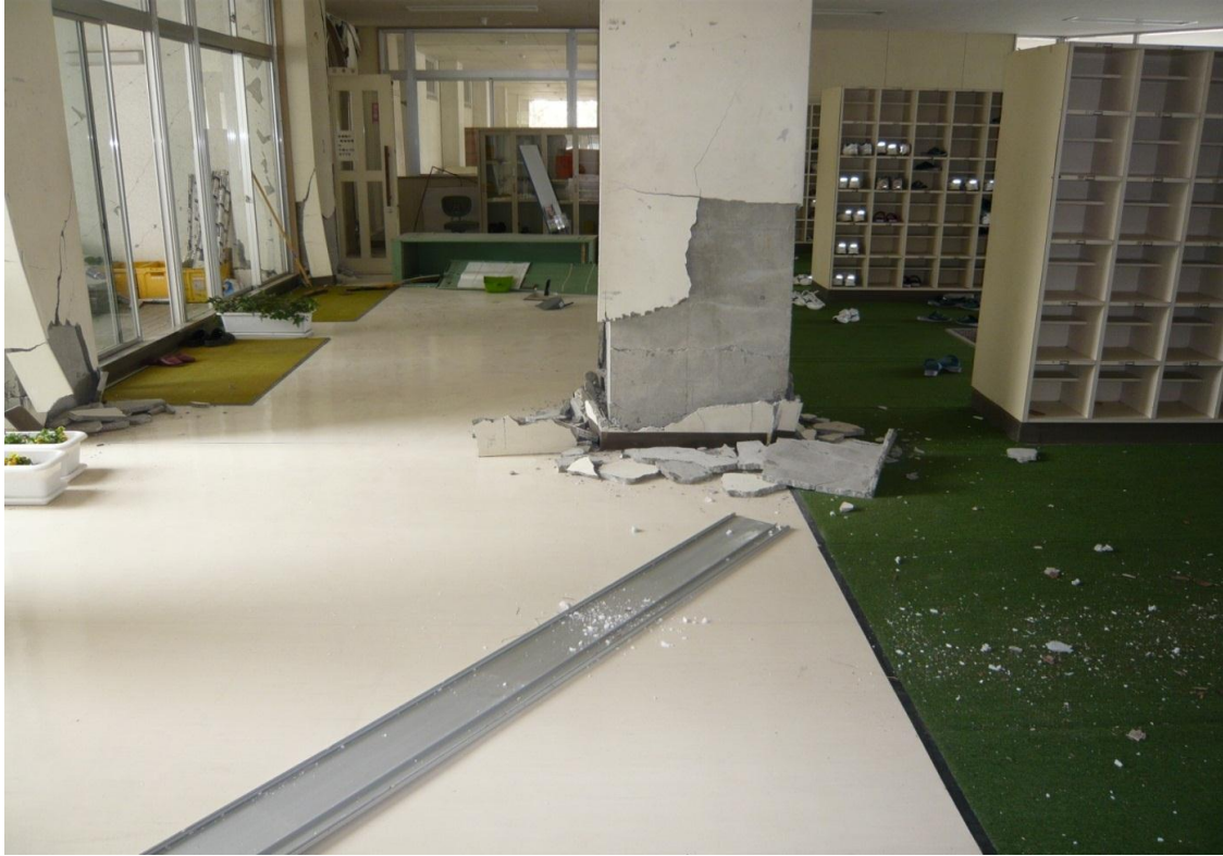
【校舎 1 階生徒昇降口の被害状況】
