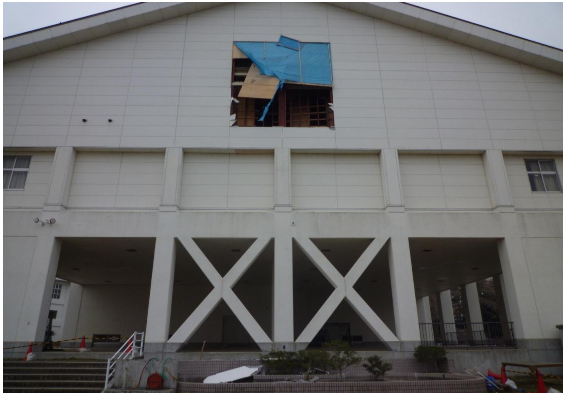
【屋内運動場外壁の被害状況】
