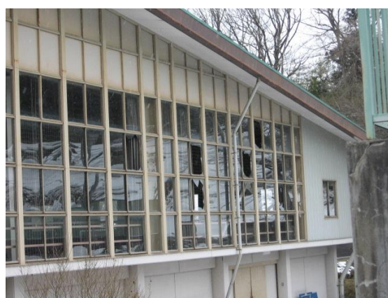
体育館等の窓ガラス破損
