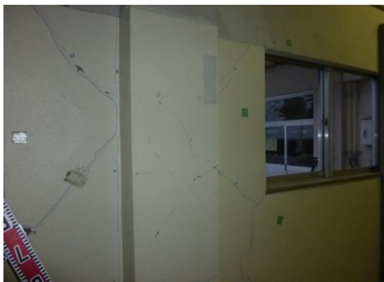
校舎の壁、柱へのクラック多数発生
