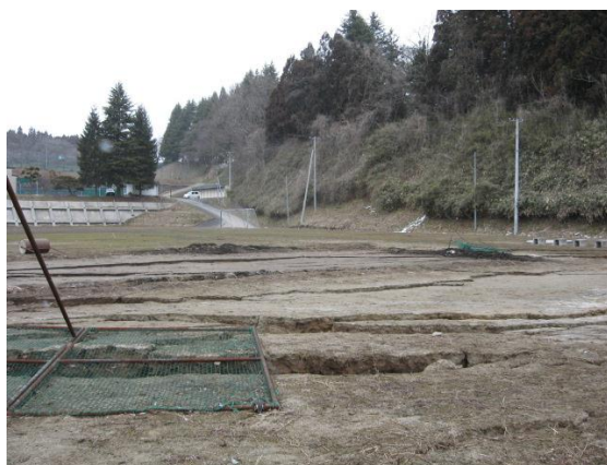
グラウンドの亀裂
