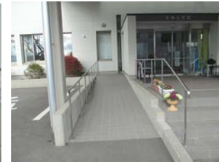
出入口の段差解消 事業費：30万円程度
