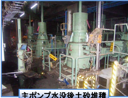
主ポンプ水没後土砂堆積
