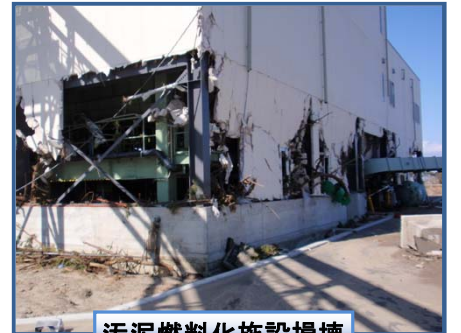
汚泥燃料化施設損壊
