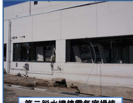
第二脱水機棟電気室損壊
