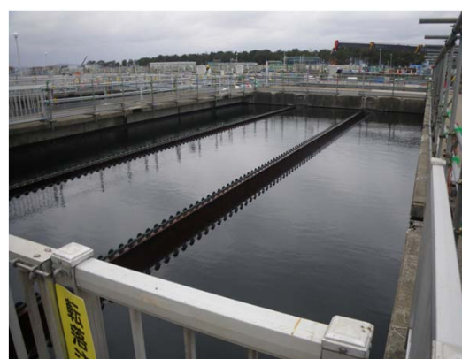
5系1/2最終沈殿池 簡易曝気実施状況
