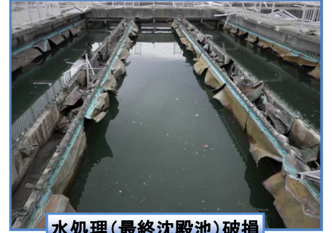
水処理(最終沈殿池)破損
