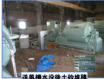
送風機水没後土砂堆積
