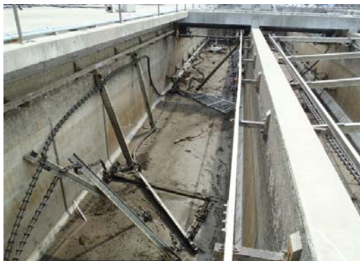
最終沈殿池被災状況
