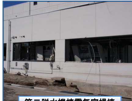
第二脱水機棟電気室損壊
