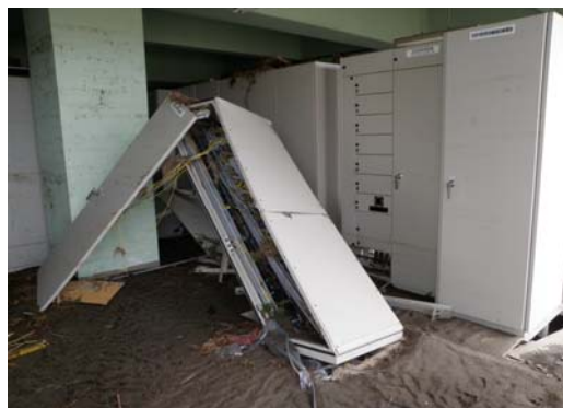
電気設備被災状況
