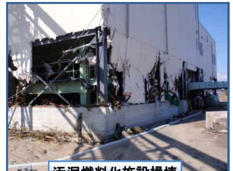
汚泥燃料化施設損壊
