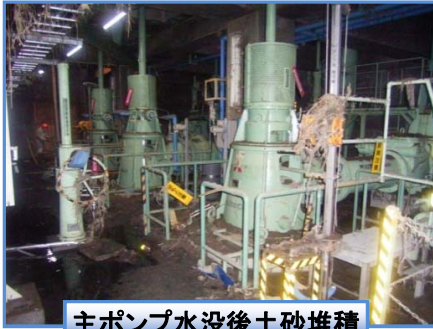
主ポンプ水没後土砂堆積
