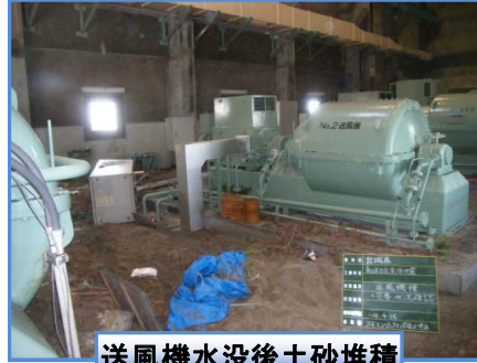
送風機水没後土砂堆積
