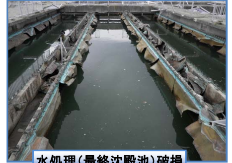
水処理(最終沈殿池)破損
