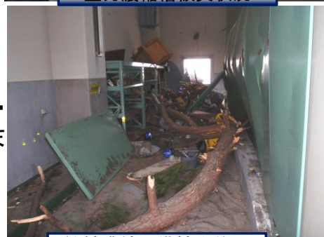
機械濃縮設備被災状況
