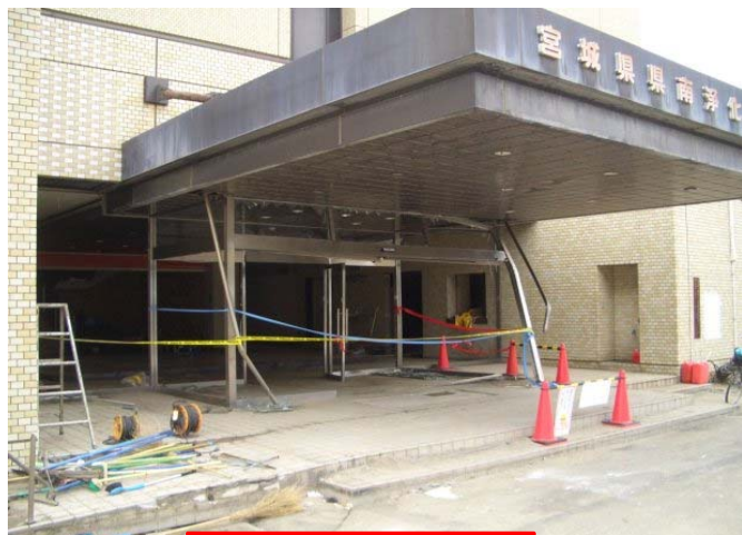
管理棟正面玄関被災状況
