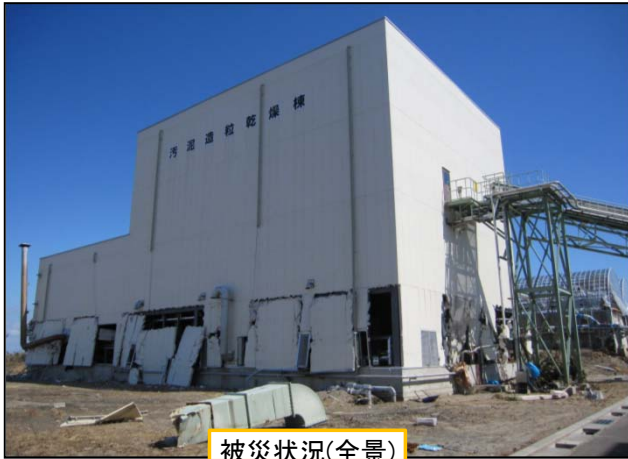
被災状況(全景)
