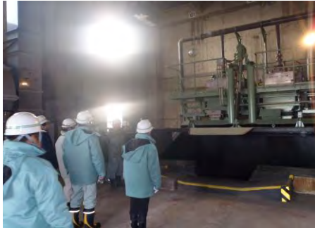
脱水汚泥投入口
