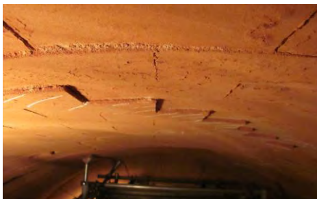
【炉内損傷状況】
