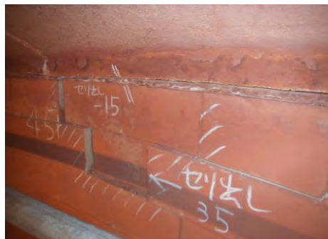
耐火レンガがせり出し
