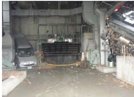
脱水汚泥投入口
