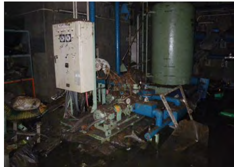
ポンプ機器水没
