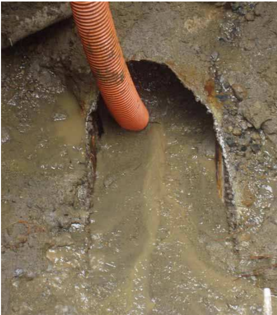
図-1 コンクリート管腐食による上部欠損状況（開削後）
