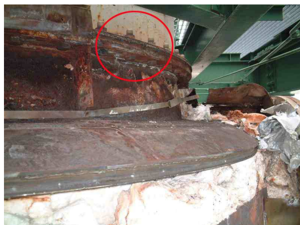
図-1 流動空気予熱器からの空気漏れ
