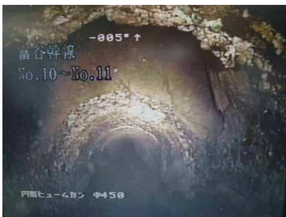
図-2 コンクリート管腐食による上部欠損状況（管渠内部）
