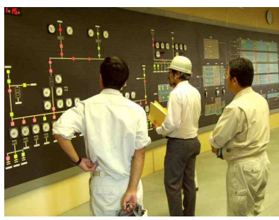
中央監視設備の状況確認
