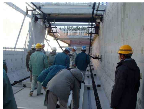
最終沈殿池内部と汚泥かき寄せ機
