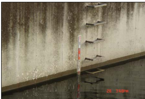
※県南浄化センター塩素混和池での，津波と慮される水面上昇（約20cm）。
