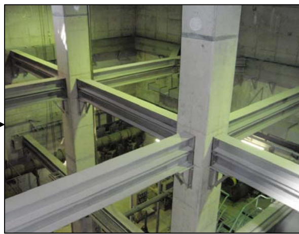
地下の機械室
