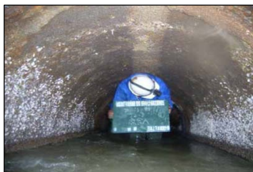
管渠劣化調査状況
