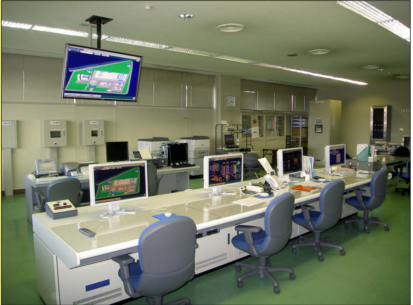
大和浄化センター中央監視設備
