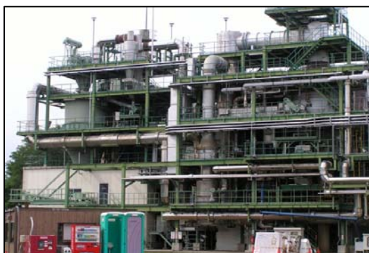
専門的な保守点検中の汚泥焼却設備
