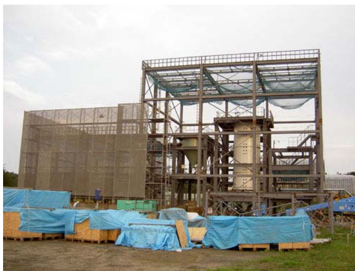
下水汚泥燃料化施設
